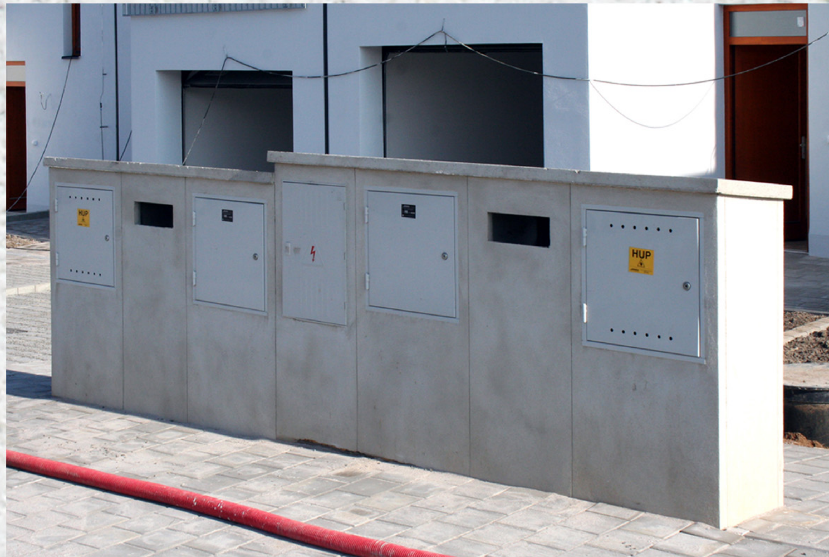
energetický pilíř pro dva domy PE5 s pilířem pro poštovní schránky - omítaný
