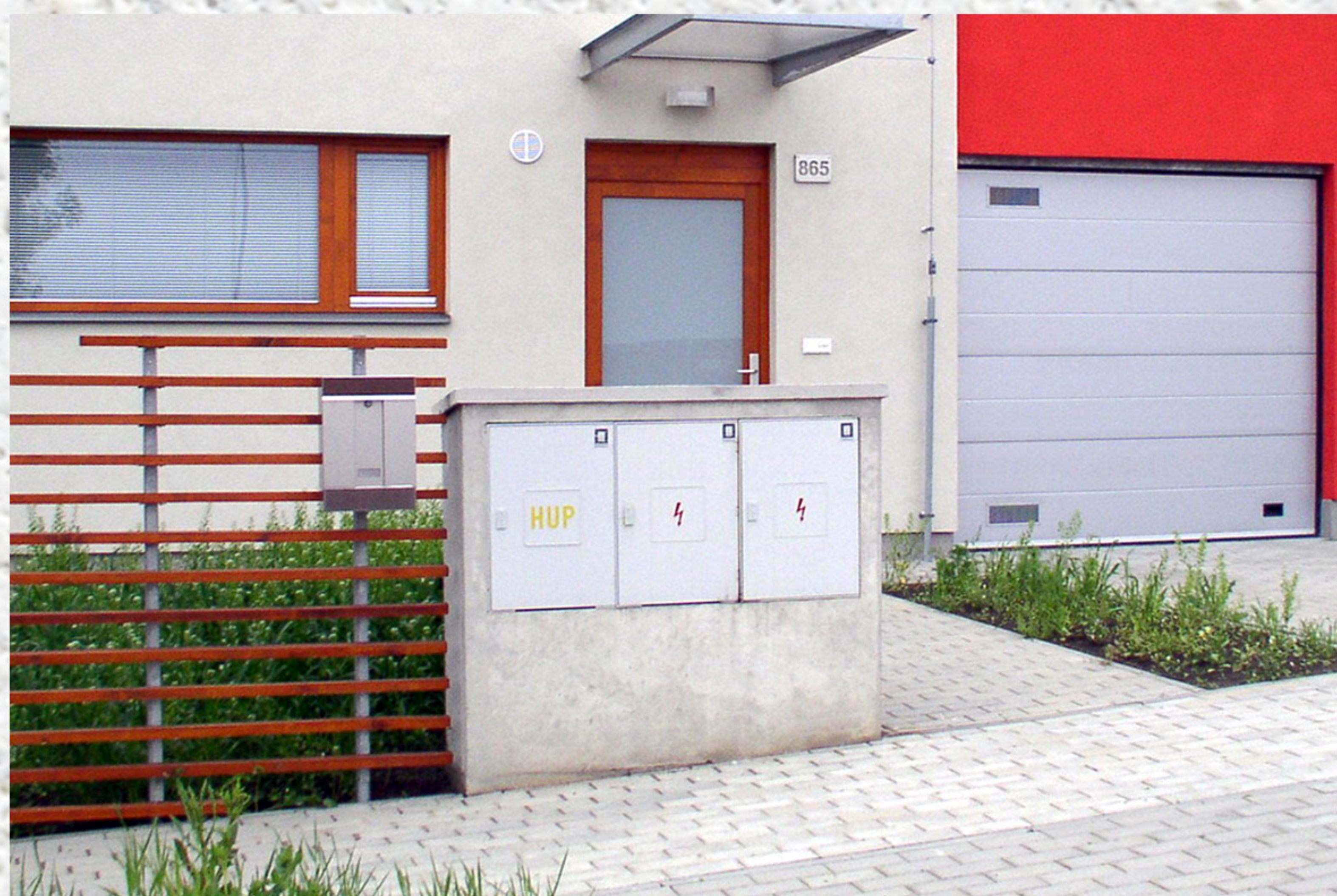
energetický pilíř s využitím plastových skříní DCK Holoubkov
