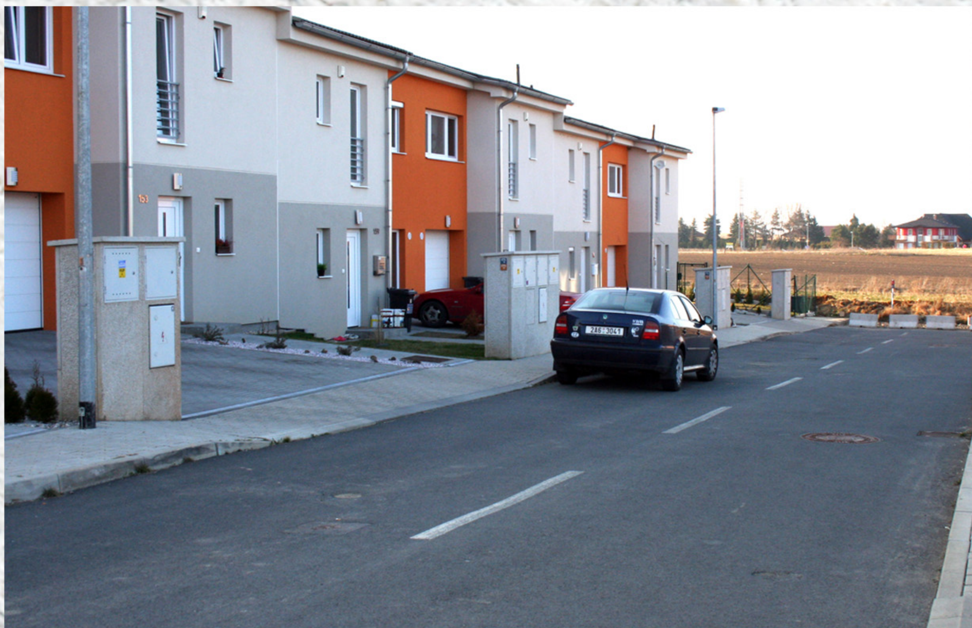
energetický pilíř vysoký s pojistkovnicí pod elektroměrovou skříní PEV
