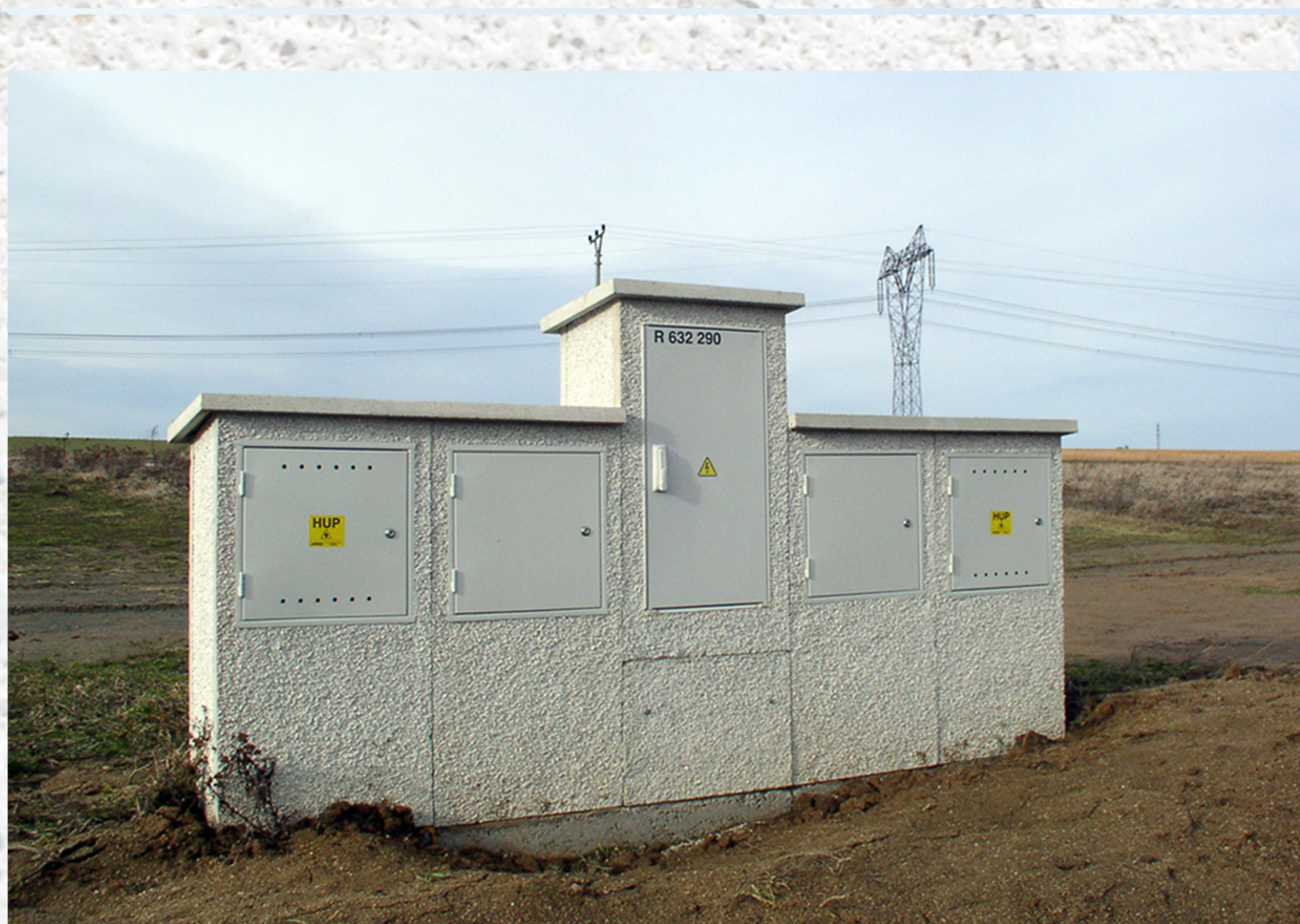
energetický pilíř pro dva domy s rozpojovací skříní SR
