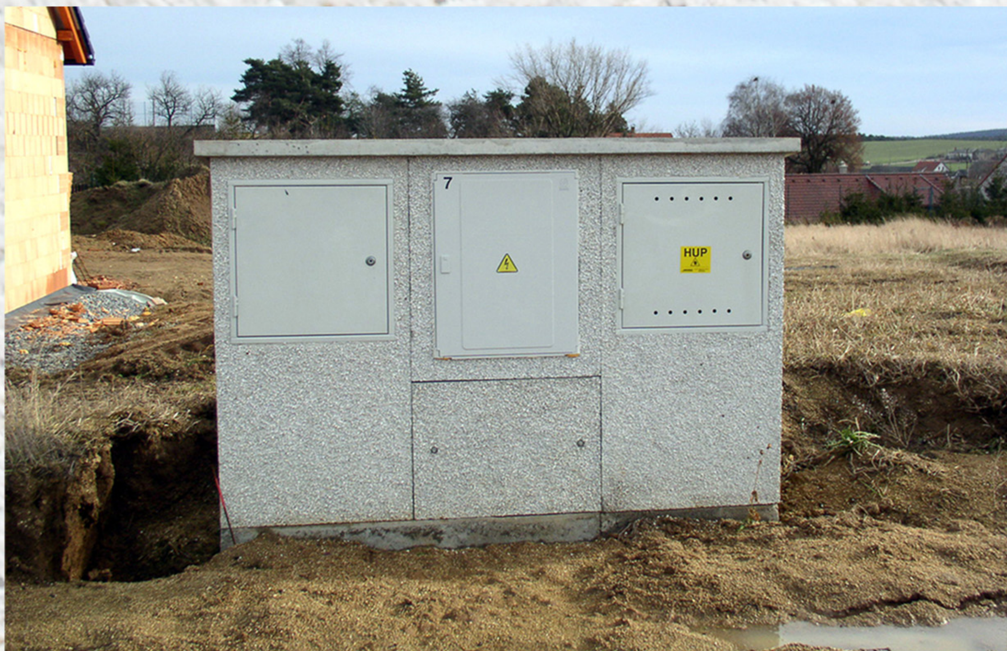
energetický pilíř pro jeden dům PE3 (E.ON)
