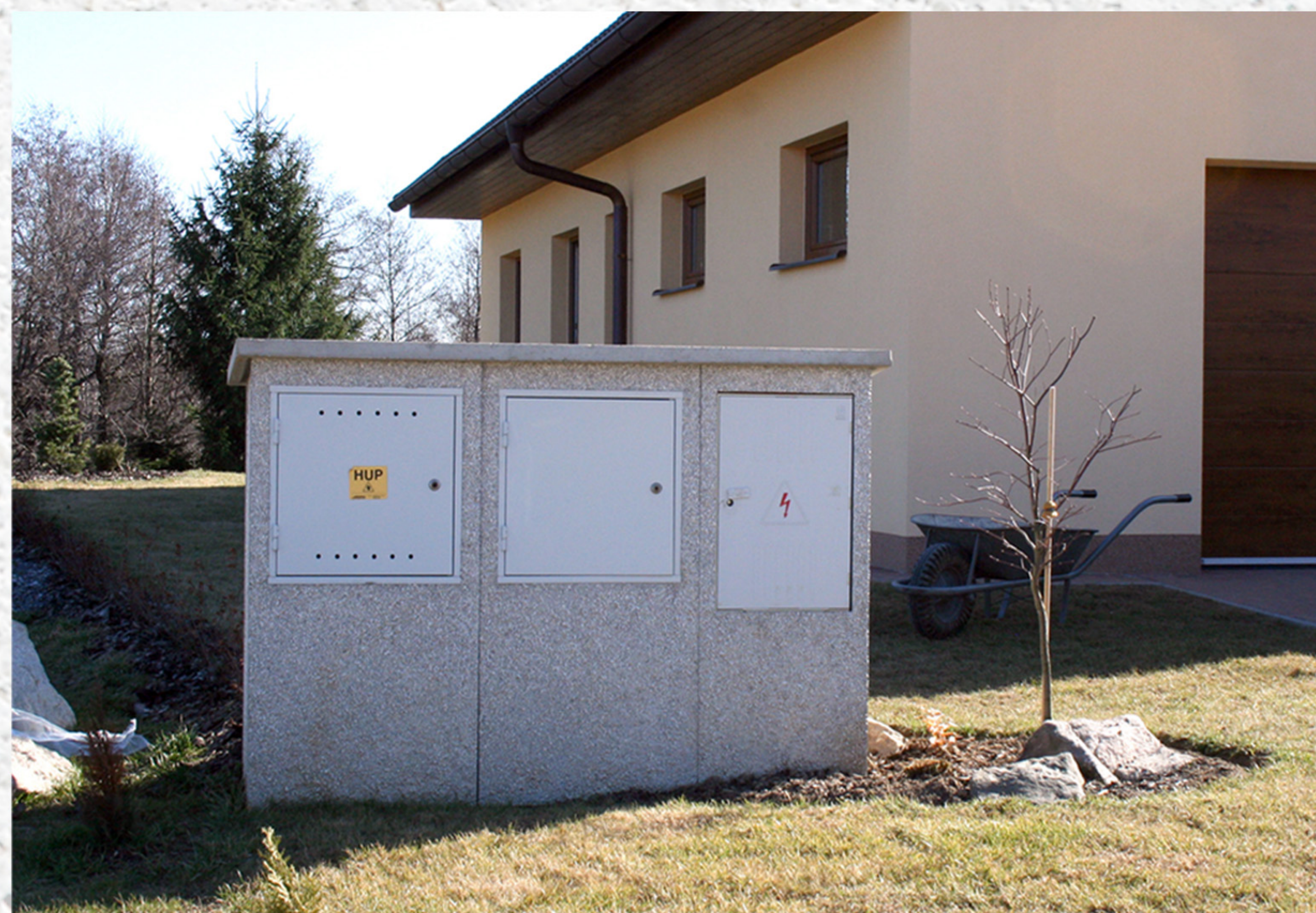
energetický pilíř pro jeden dům PE3
